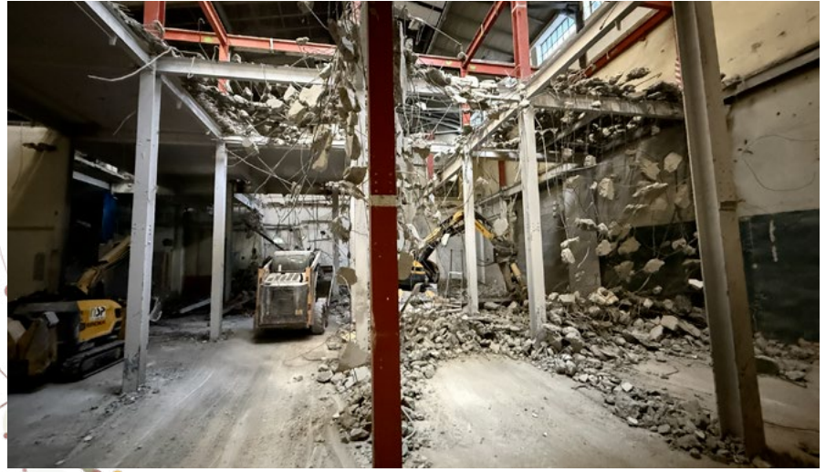
Fra rivingen på byggeplass. Dette blir Vestibylen i det nye teaterhuset. Foto: Kloden teater.
